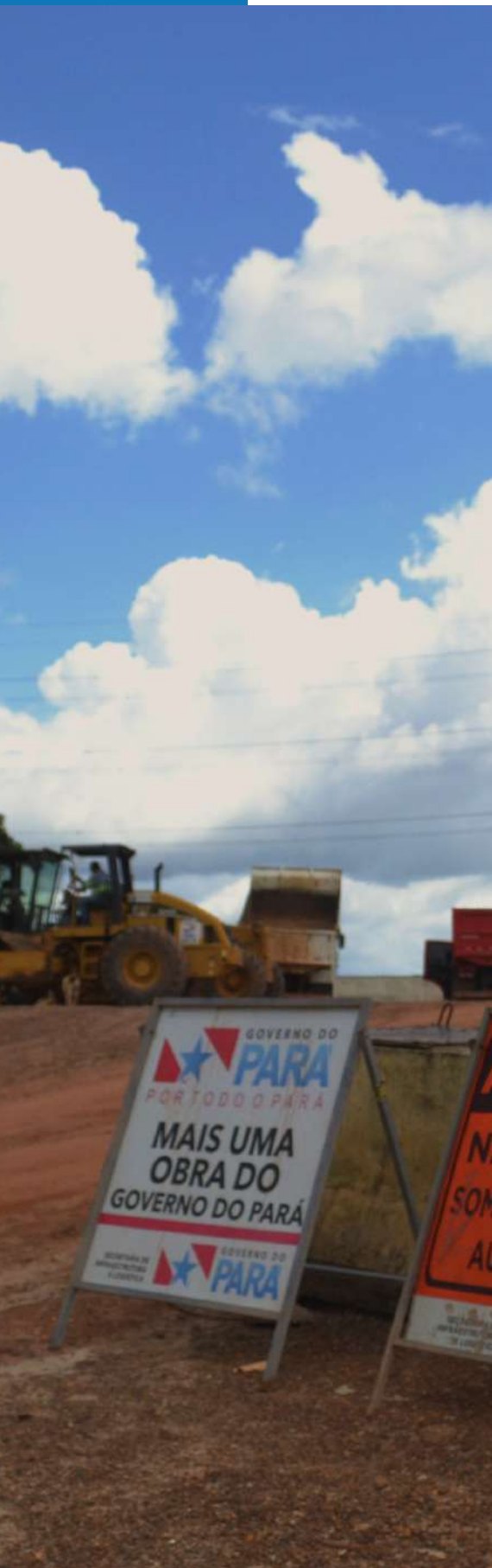
Foto: Implementação da Avenida Liberdade, margeando o território do Quilombo Abacatal, junho de 2025.
